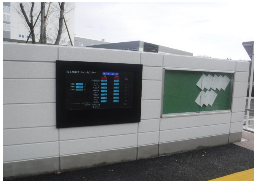
●公害監視モニター設置状況
