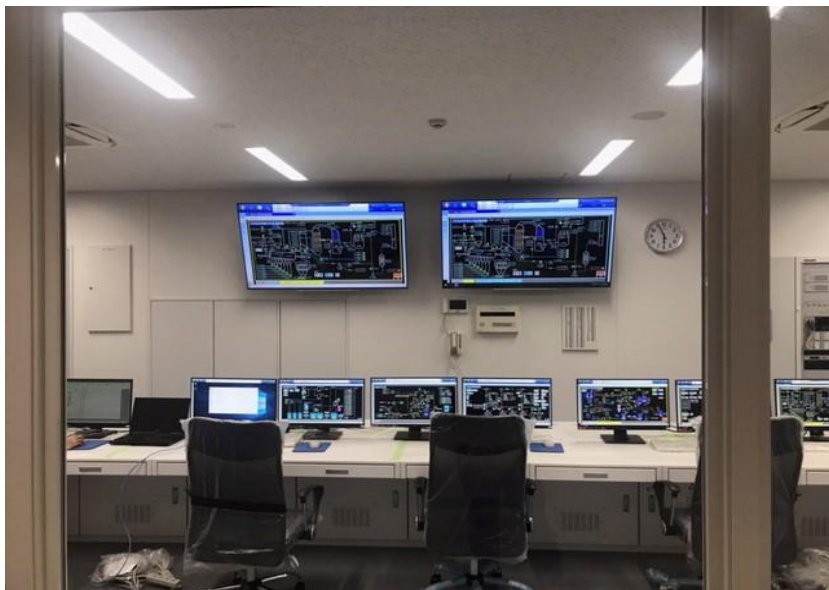
● 中央制御室モニター設置状況
