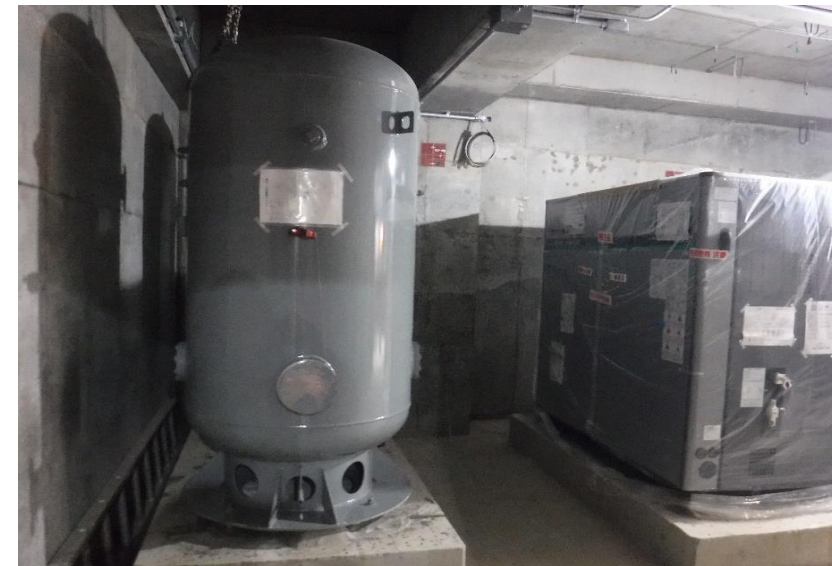
●空気圧縮機、空気槽取り込み状況
