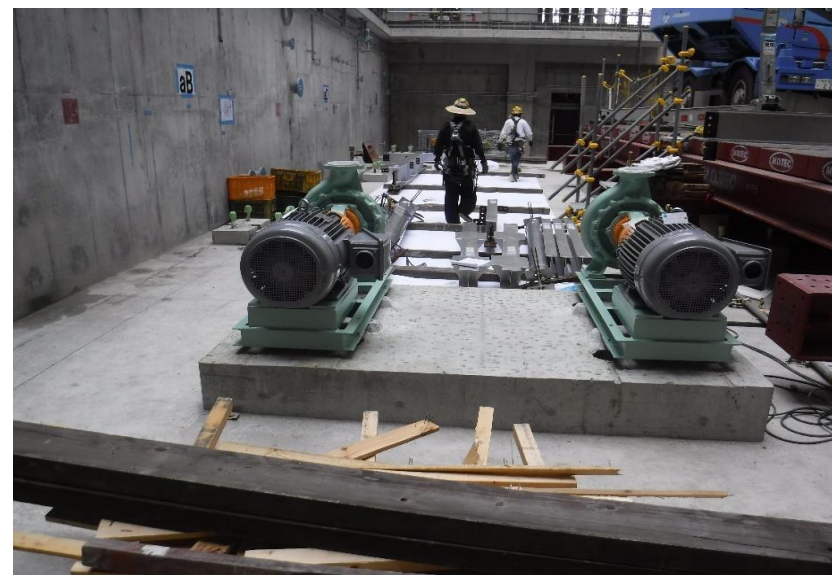
●機器冷却水ポンプ取り込み状況
